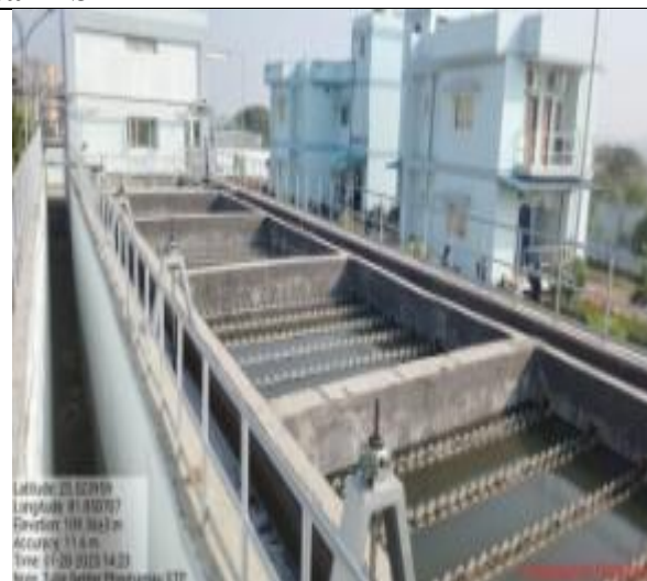
Phaphamau STP (Tube settlers)
