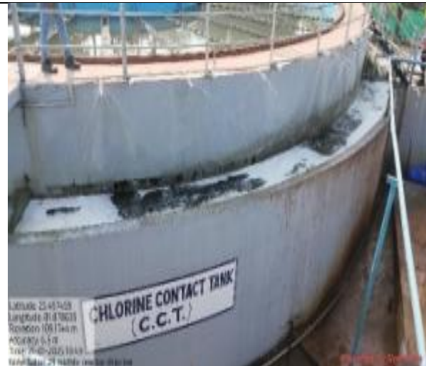
Salori29 MLD STP(CCT)
