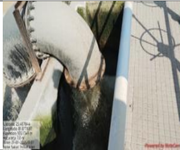
Salori14 MLD STP(Inlet)
